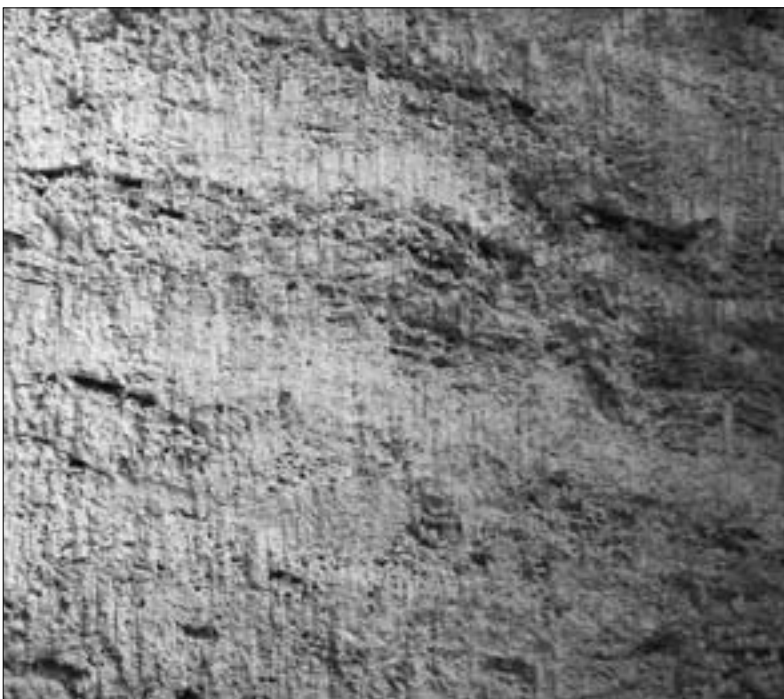
Рис. 22. Природное пористое строение пудостского камня (отмытая дождём поверхность пилястра у западного входа в служебные помещения Казанского собора). Фото А. Г. Булаха. 9 сентября 2011 г.
