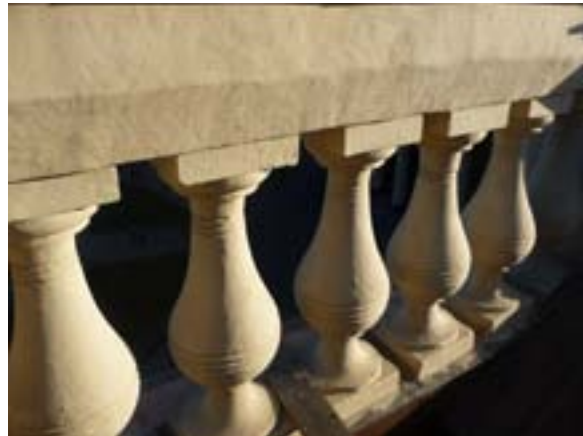
Илл. 16. Окончательный вид балюстрады после реставрации 2011 года. Фото А. Г. Булаха. 9 ноября 2011 г.
